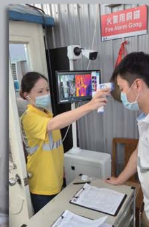
於工地入口為所有進入工地的人士量度體溫 Body temperature checking for all persons entering the construction site
